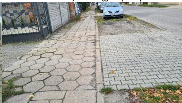
Fot. Ulica Polna – zły stan ciągów pieszych
