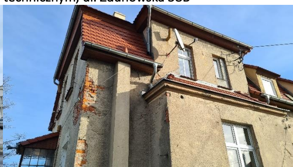
Fot. Budynek komunalny w złym stanie technicznym, ul. Zdunowska 58B
