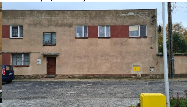
Fot. Budynek komunalny w złym stanie technicznym, ul. Fabryczna 10a
