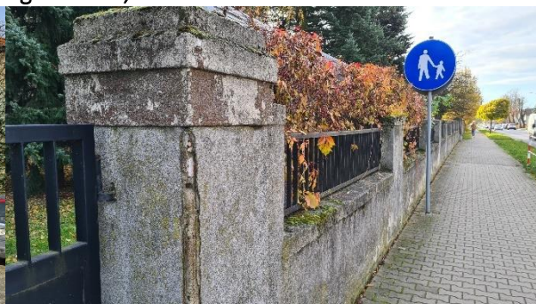
Fot. Szkoła Podstawowa nr 5, niszczące ogrodzenie, ul. Zdunowska 83
