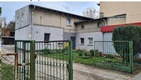
Fot. Budynek komunalny w złym stanie technicznym, ul. Słodowa 5
