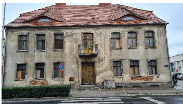
Fot. Budynek niszczący, ul. Sienkiewicza 14
