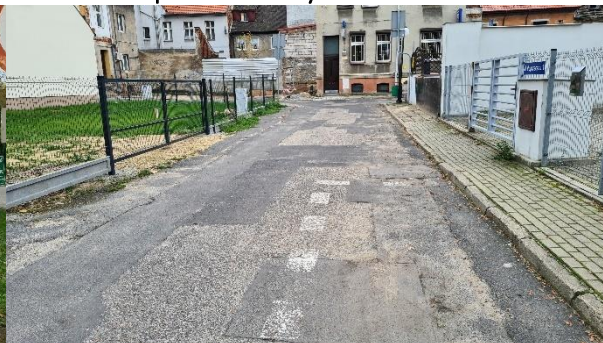
Fot. Ulica Poprzeczna – zły stan nawierzchni
