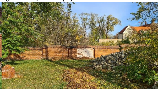
Fot. I Liceum Ogólnokształcące, niszczące ogrodzenie, ul. Kołtąja 1
