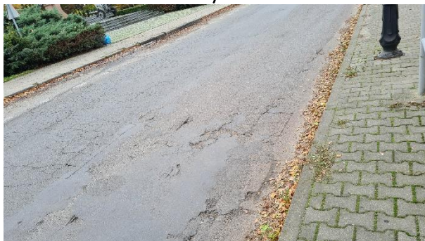
Fot. Ulica Piastowska – zły stan nawierzchni
