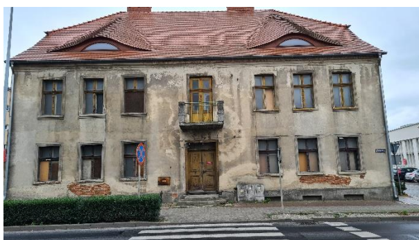
Fot. Budynek niszczący, ul. Sienkiewicza 14
